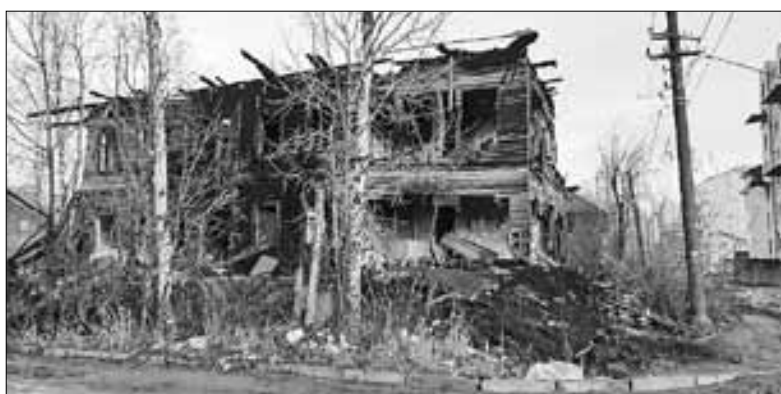
■ Сгоревший дом на ул. Володарского
