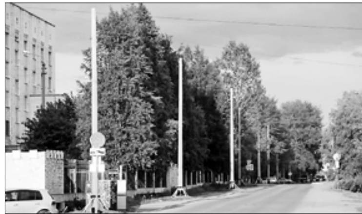
■ Новые опоры освещения на пр. Новгородском. ФОТО: WWW.ARHCITY.RU
