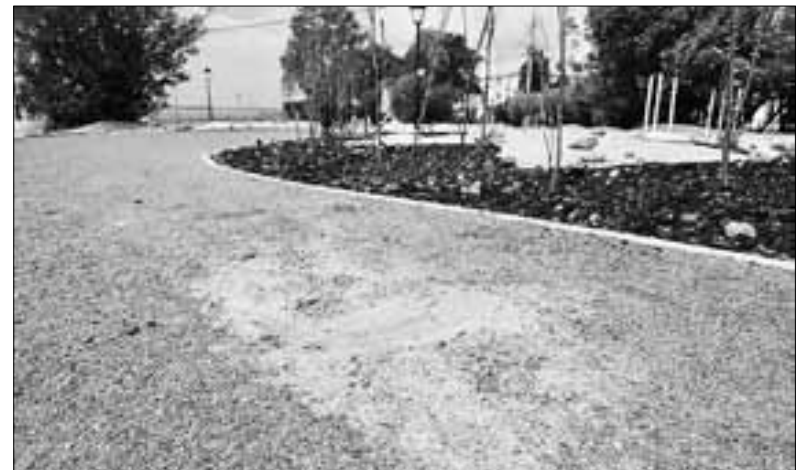
■ Тонкий слой гранитной крошки уже разрушается
