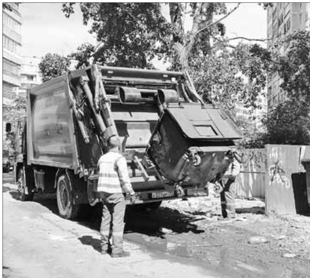
■ Новые контейнеры, установленные «ЭкоИнтегратором», можно использовать при технологии задней загрузки в мусоровозы. ФОТО: СОФЬЯ ЦАРЕВА
