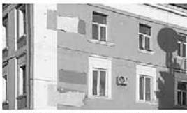
Плохо. Фасад здания поврежден информационными конструкциями
