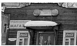
Плохо. Вывески грязные и в неисправном состоянии
