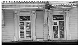
Плохо. Элементы оформления полностью закрывают оконные проемы.
