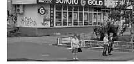
Плохо. Дублируется одна и та же информация на плоскости фасада и в проектах светопрозрачных конструкций.
